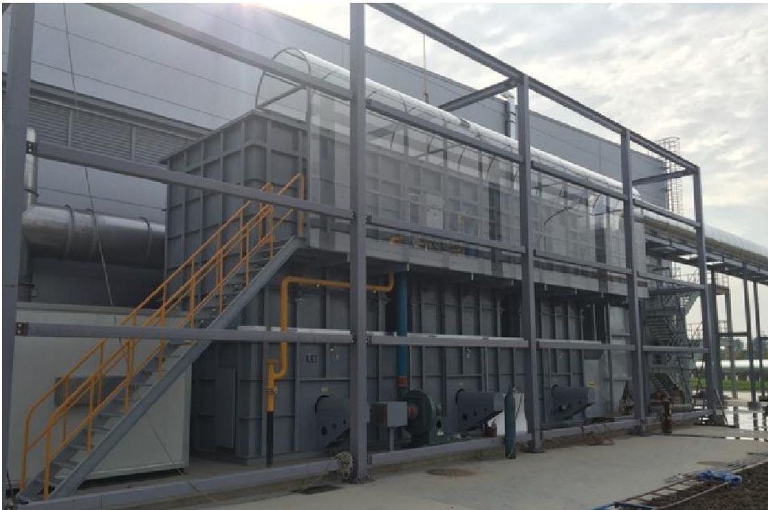
图 6.1.2-5 RTO 设备实物照片
